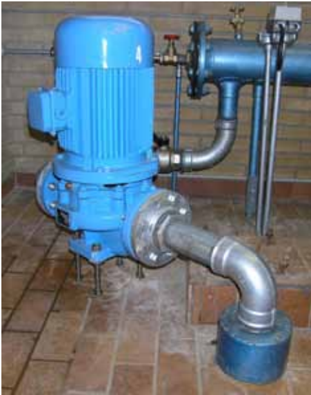
VLMT 80-80/200 FELSTED VANDVÆRK
